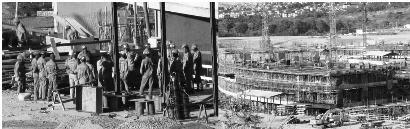
Obras do Centro Administrativo: irregularidades e desrespeito aos direitos trabalhistas
