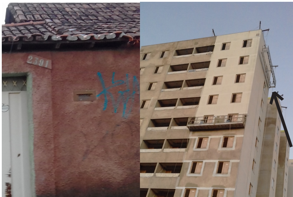
A casa que teve o telhado atingido e o andaime no 17º andar do prédio, que soltou o fundo
