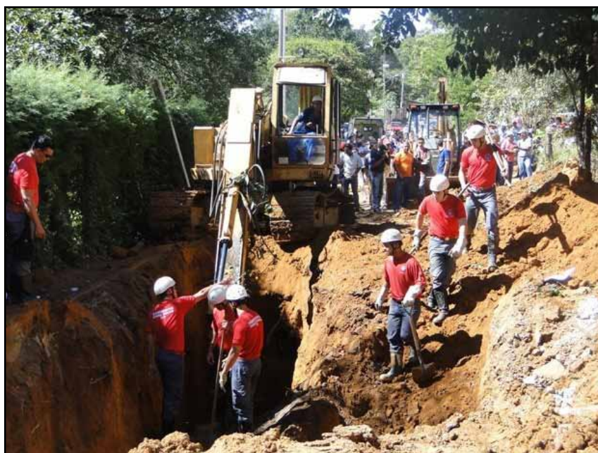
Obra irregular da prefeitura de Confins e Copasa enterrou vivo dois operários
