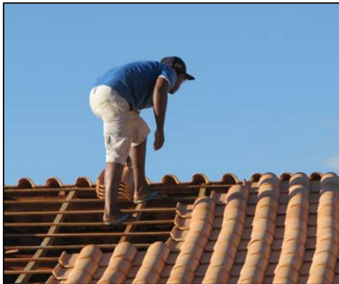
Trabalhador são obrigados a trabalhar de chinelo, sem cinto e sem capacete, correndo risco de acidentes
